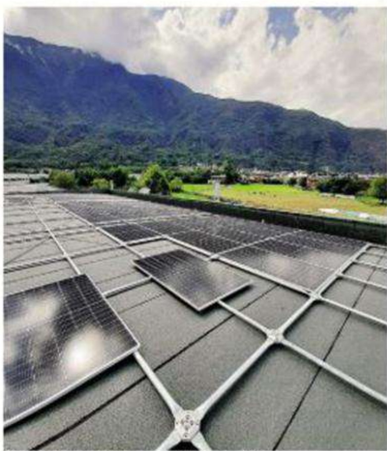
L'intervento realizzato nello stabilimento di Nbc Elettronica Group a Delebio
